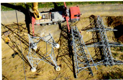
En 2010, RTE a construit une nouvelle ligne à 225.000 volts entre Moulaine (Moselle) et Aubange (Belgique).
